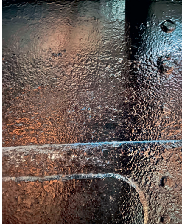
5 Auf diesem Foto ist eine der größeren aufgeschweißten Platten zu sehen. Auch der Unterschied in der Oberflächenstruktur entlang der Wasserlinie ist gut erkennbar.
