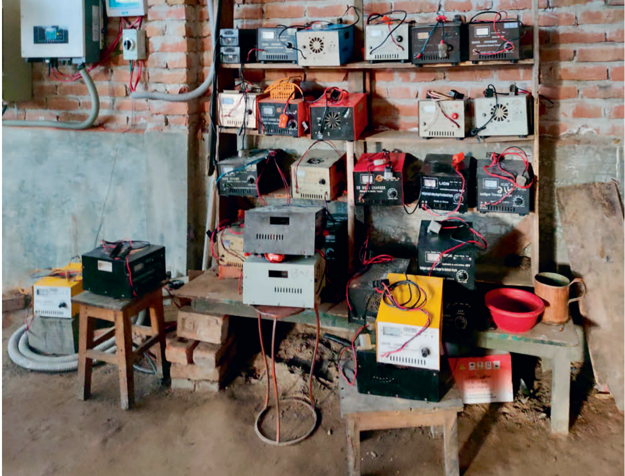
9 Stromzähler und Equipment zum Laden der Easybikes, Rajshahi
